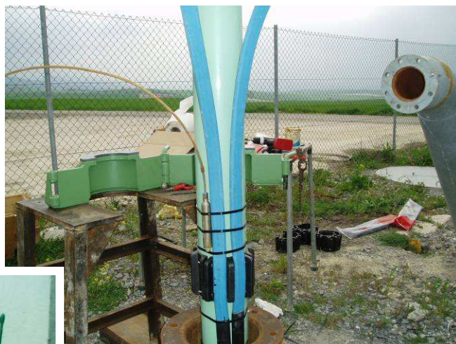
Detalle de la sujeción de los cables
