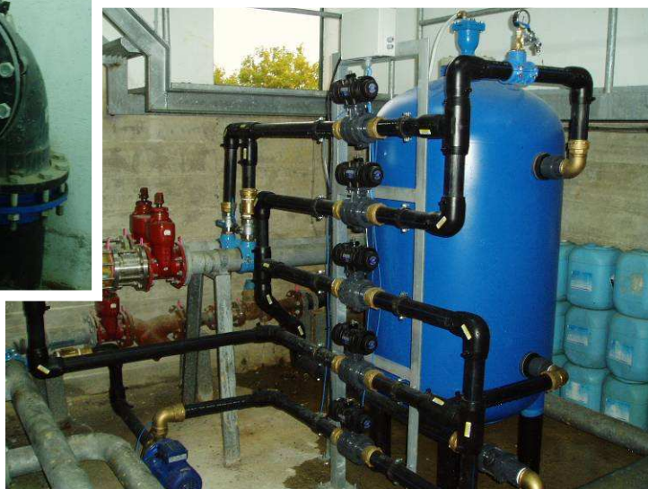
Equipo de filtración con limpieza automática
