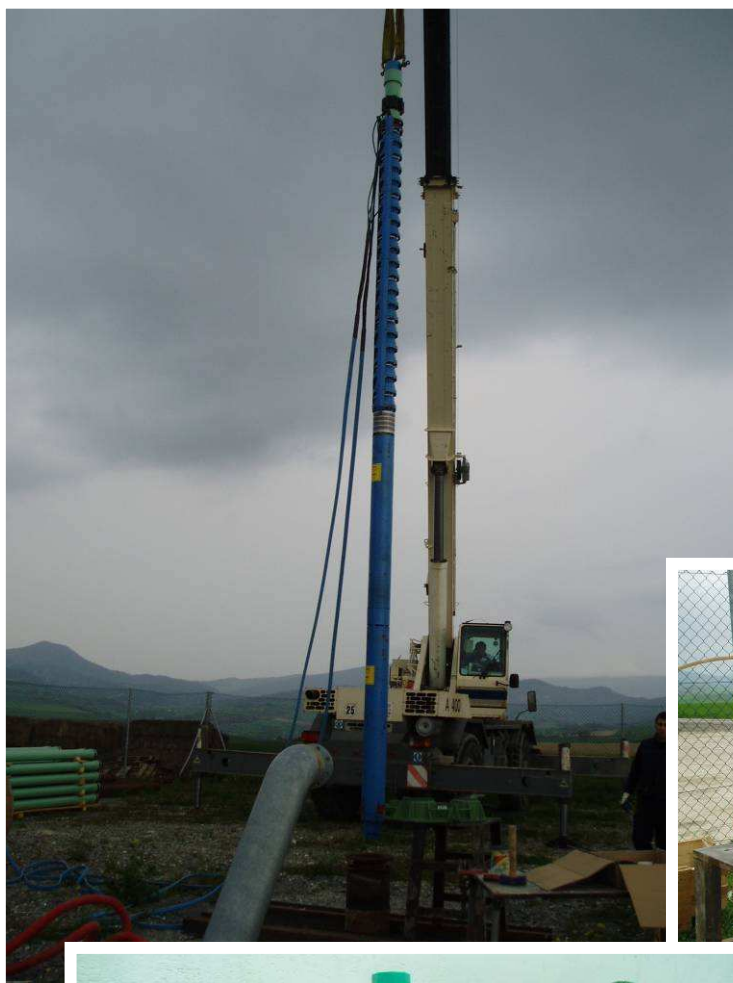
Vista general de la bomba instalada
